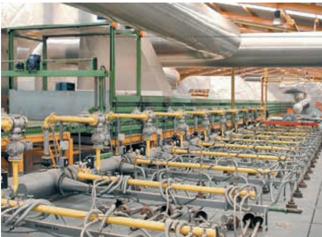
Quemadores de biogás en la planta de Piera Ecocerámica
