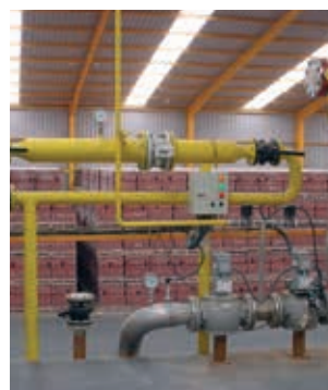
Canalización del biogás
